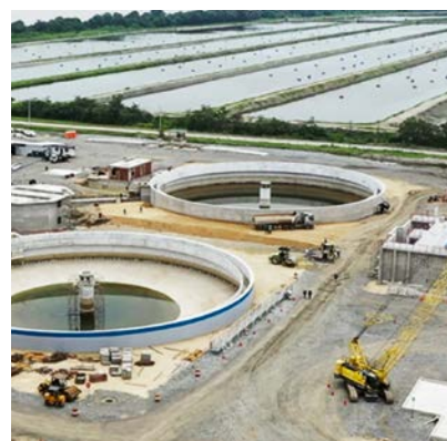
In Guayaquil, Ecuador, liefert Sika Produkte für eine neue Abwasserreinigungsanlage. Eine Million Wohnungen werden daran angeschlossen.
